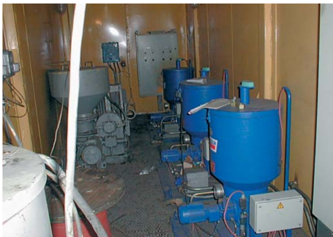
Размещение смазочного оборудования на ЭШ 25.90
