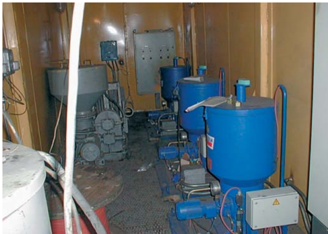
Размещение смазочного оборудования на ЭШ 25.90
