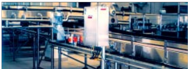
Секция разливочной линии с эжекторным шкафом
